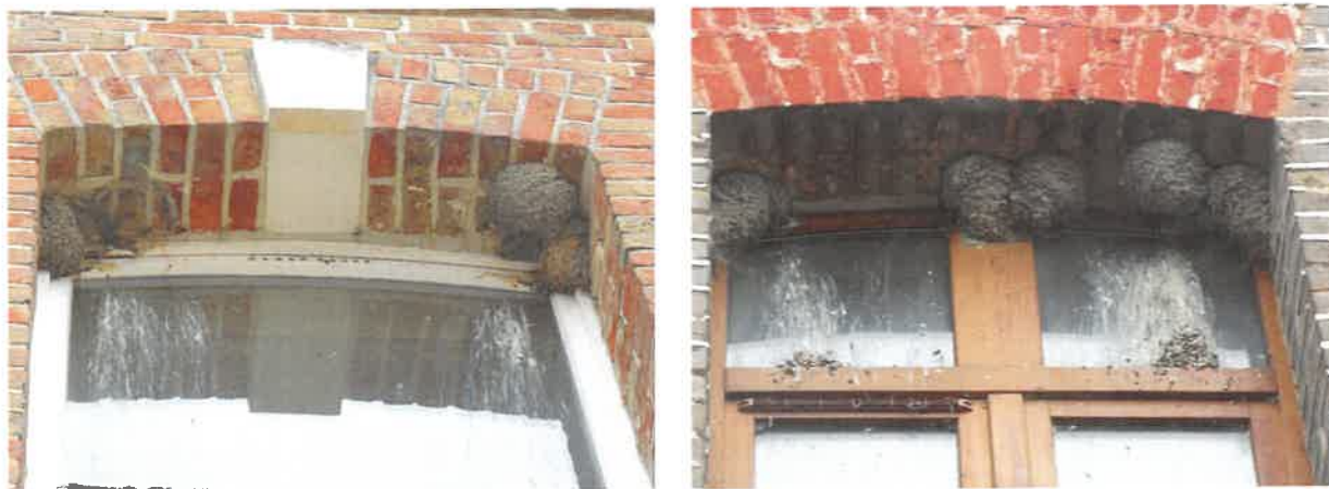
Nids d'hirondelles présents sur les façades, côté cour (à gauche) et côté rue (à droite) - Photo : L. Leite
